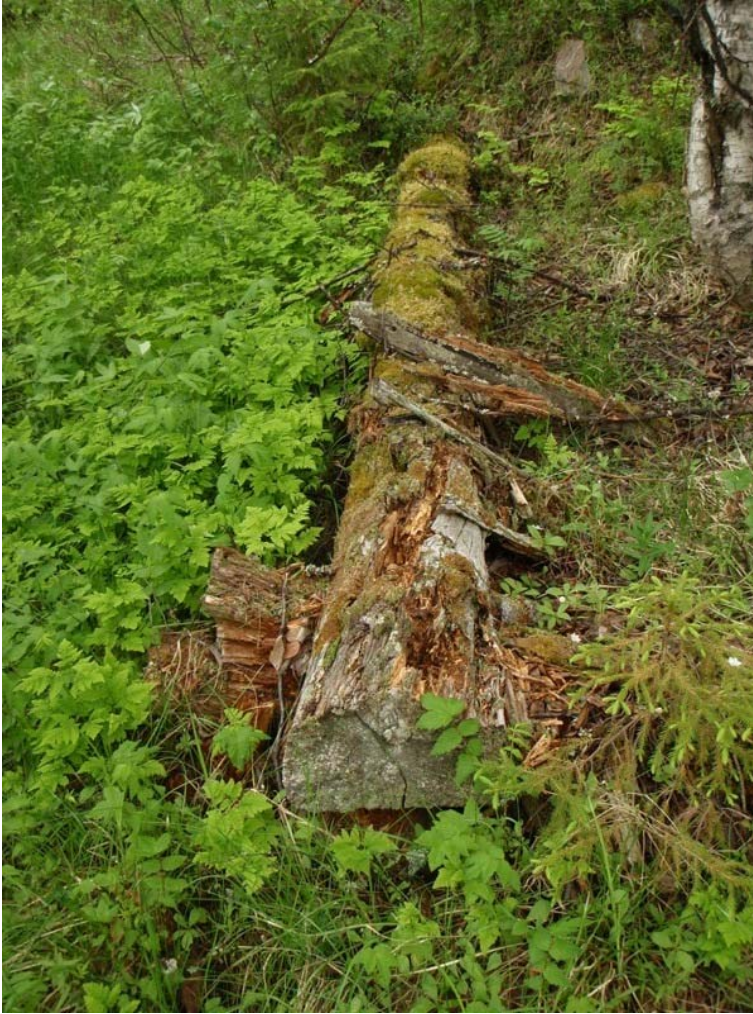
Kuva 12. Syvälampi 3. Saunan lahonnut hirsi.
