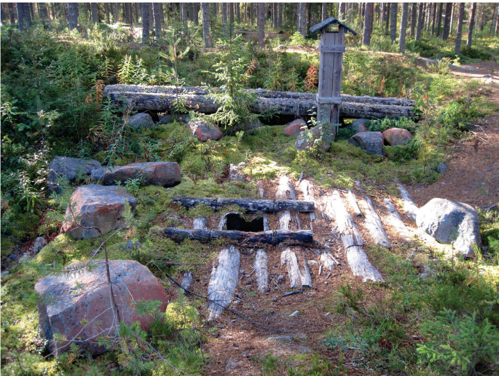
Kuva 10. Aidatun korsun 2 katto-osa. Kattopuu ovat lahonneita, eikä niillä ole turvallista kävellä. Kuvattu pohjoisesta.
