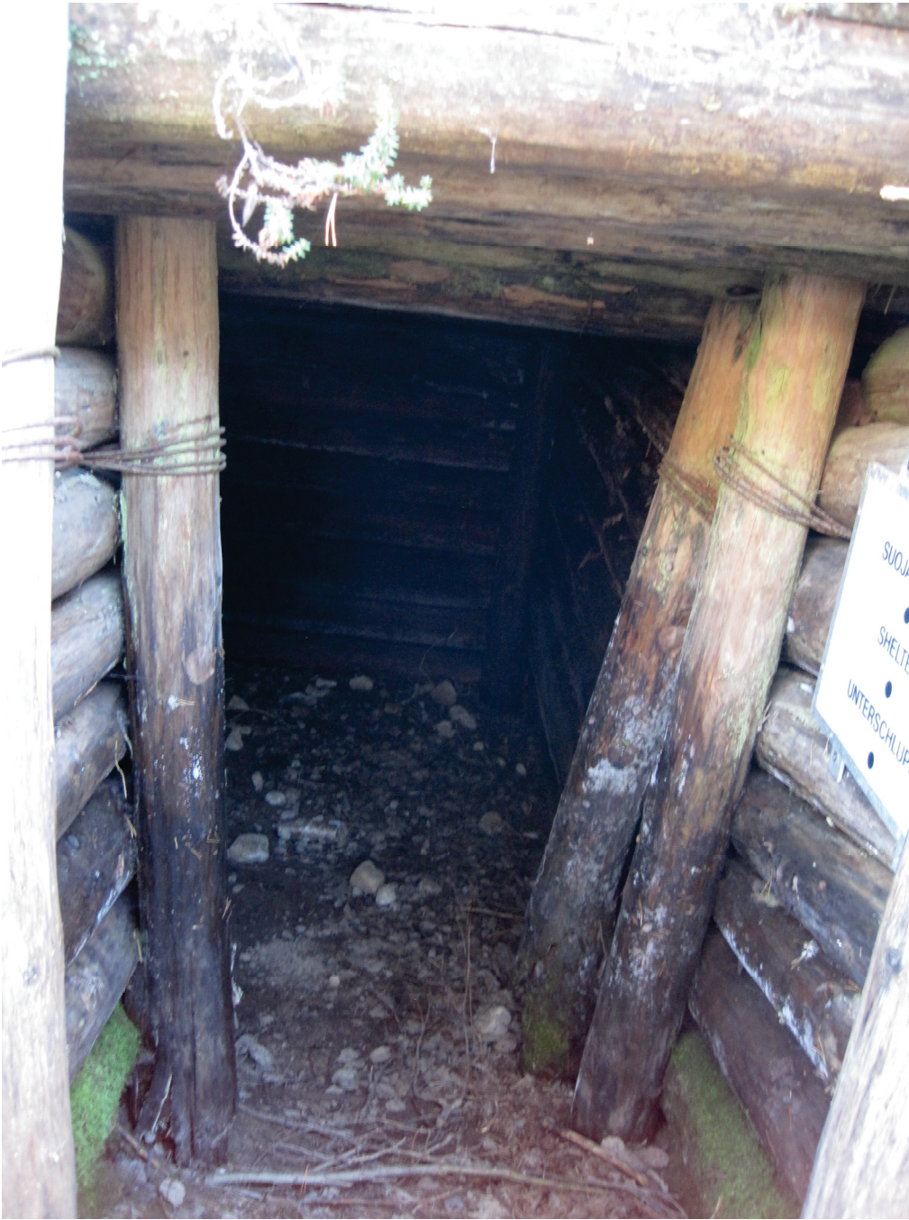
Kuva 15. Suojakomeron suuaukko. Puiassa selvästi lahoamisvaurioita. Komeron katto sisäpuolelta katsoen vielä vaurioton. Kuvattu pohjoisesta.
