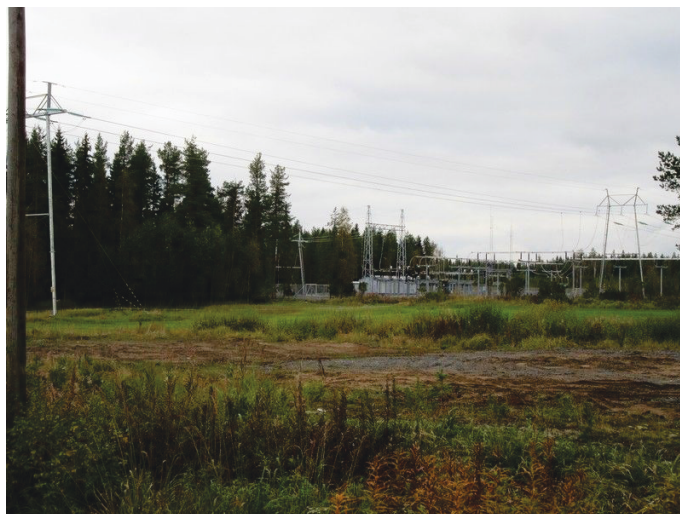
Kuva 20 VL. Pyhäkosken sähköasema kuvattu luoteeseen.
