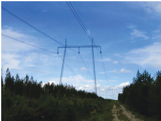
Kuva 14. Voimalinja hankealueen itäosassa kuvattu koilliseen.
