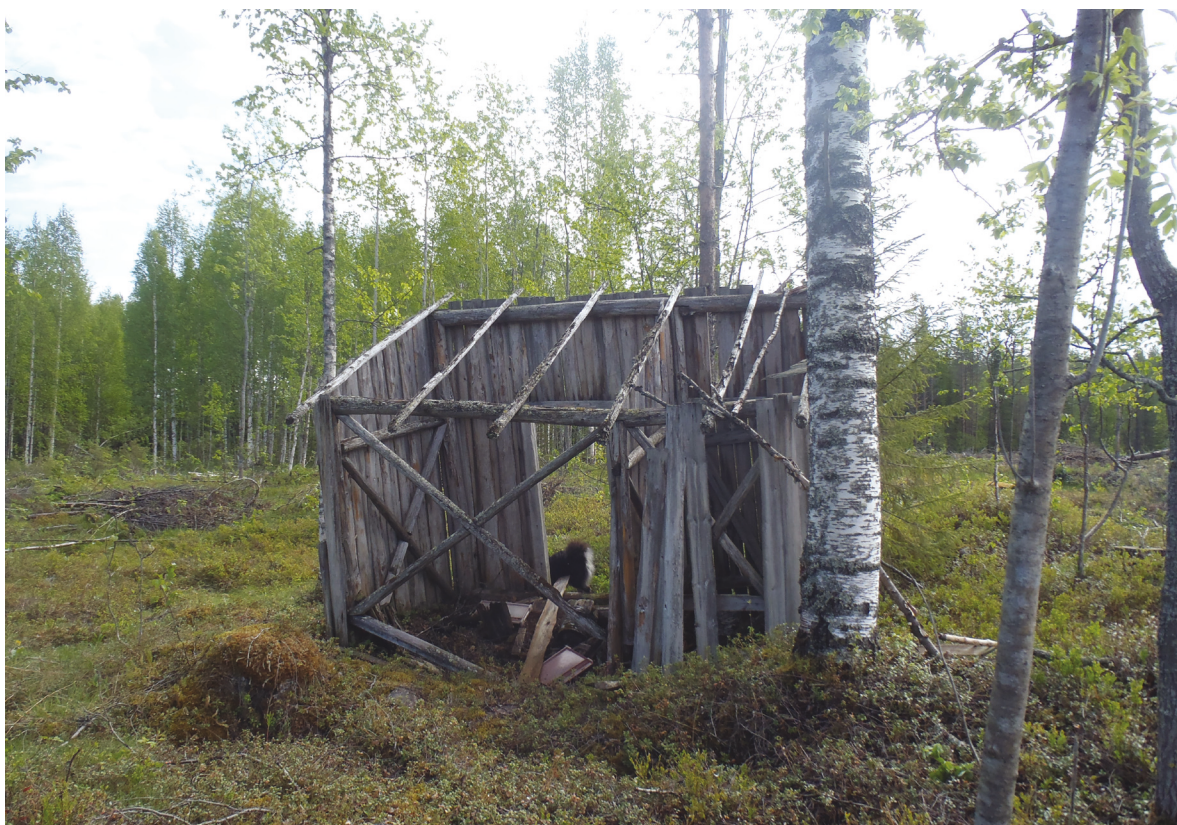
Kuva: 179710.P1010004. Sikopuron ulkovessa on kattoa myöten pystyssä, vain takaseinä on lahonnut pois.
