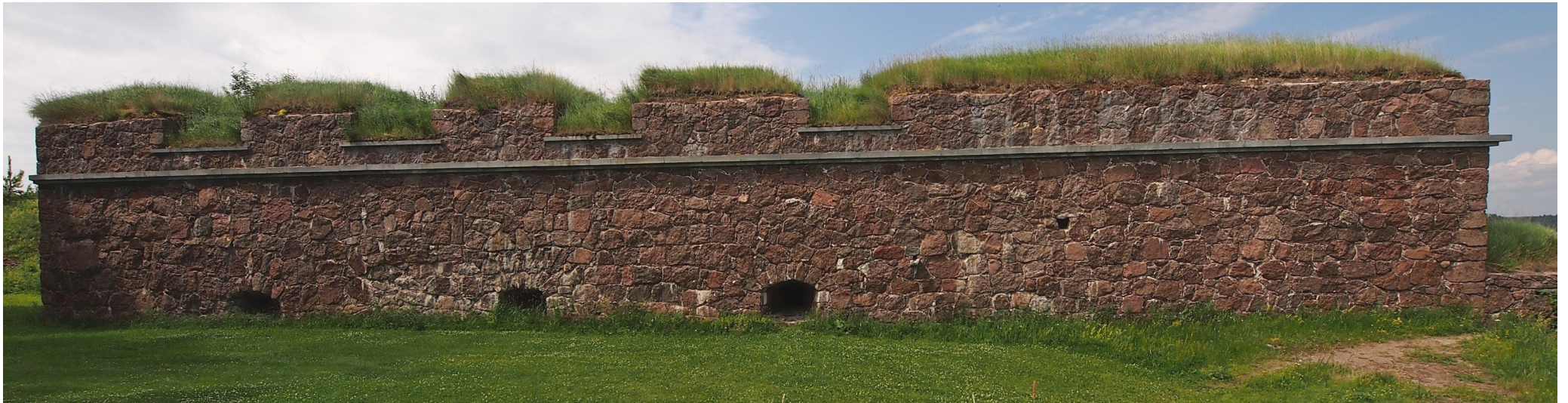
Qweckfeldtin itäsiipi. Keskimmäinen kasematin ampuma-aukko vaatii korjausta.
