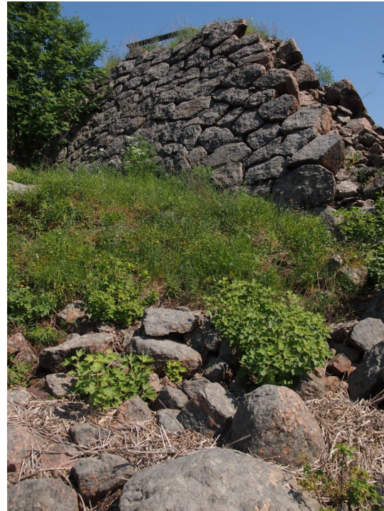
Kärki on sortunut. Pohjois-eteläsuuntaisessa muurissa on pullistumaa ja keskellä sortuma.
