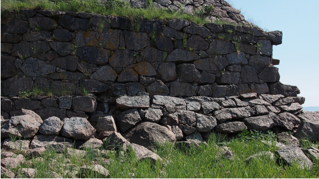
Pohjois-eteläsuuntainen pitkä muuri—sortunut kärki.
