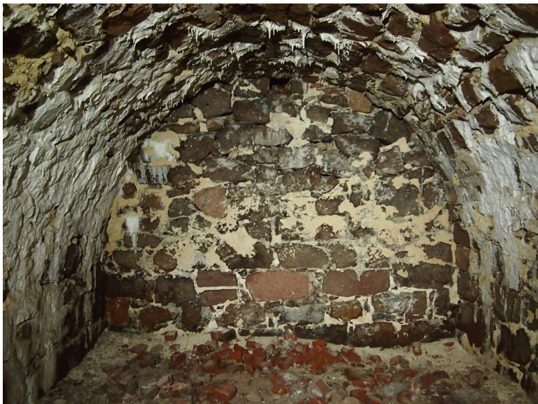
Kasemateissa on runsaasti valumajälkiä. Yllä olevassa kuvassa näkyy myös alkuperäistä pintakäsittelyä kasematin päätyseinässä.
