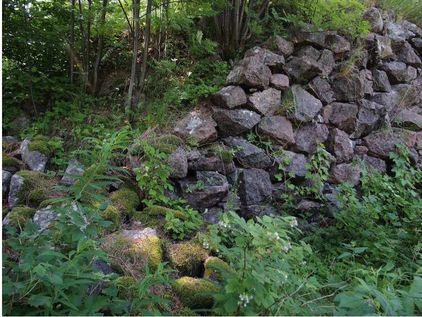
Raveliinin pohjoisosa, jonka länsipää on erityisen vaarallinen..
