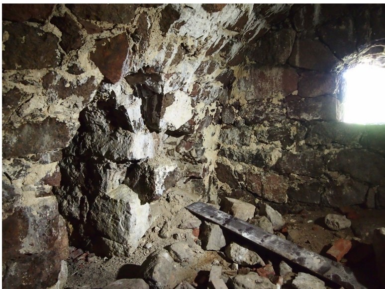
Pieni sortumakohta kasematin sisäseinässä lähellä bastionin kärkeä
