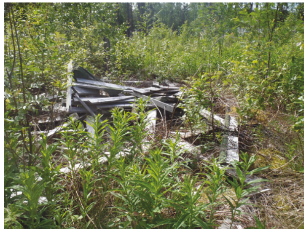
172429.3.041: Vessaksi arveltu rakennus on romahtanut lautarakennus, jossa on ollut vihreä huopakatto.
