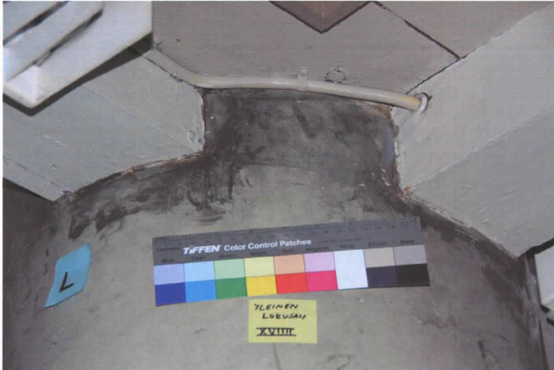
Yleisen lukusalin pylväs 19. Palkkien paino on halkaissut kuorikerroksen.
