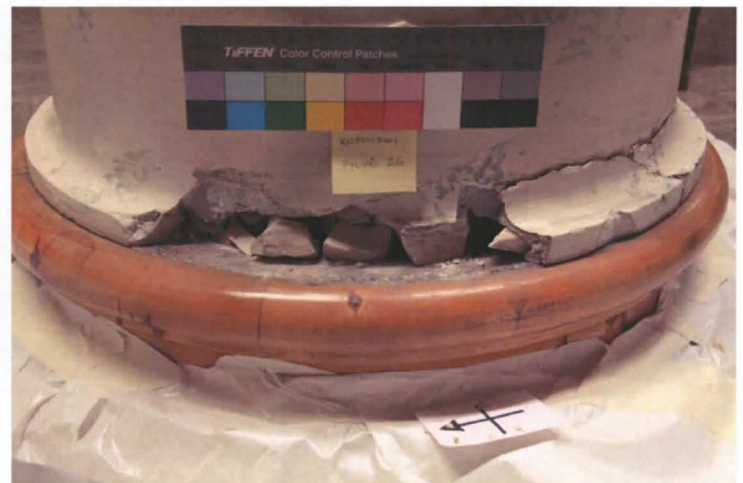
Kupolialin pylväs 26, kipsin paloja kipsikorjauksen seassa.
