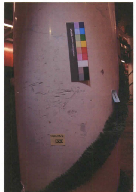
Kupolisalin pylvään 21 naarmuja.
