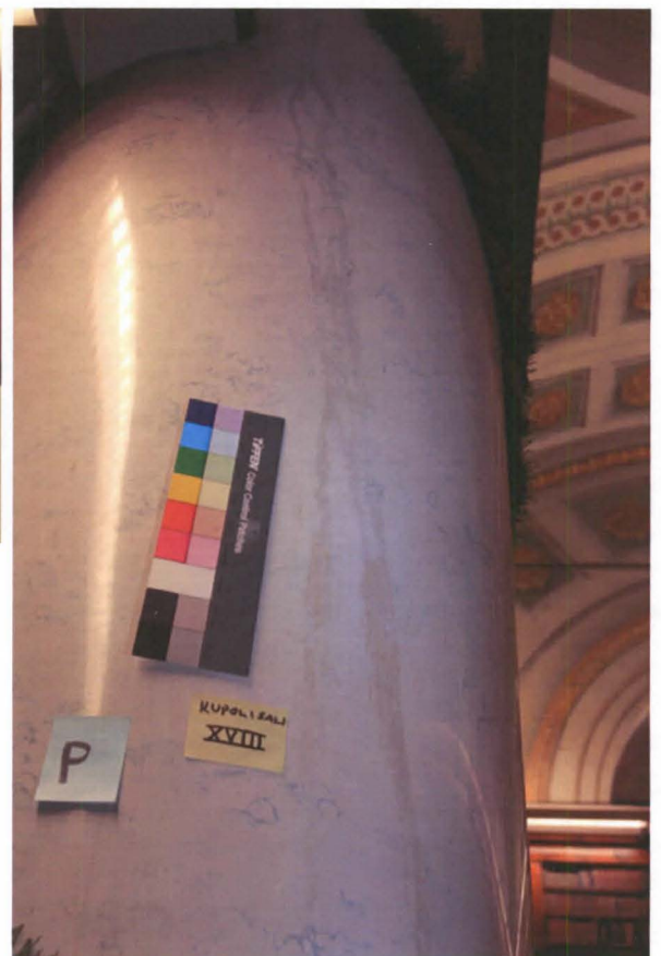
Kupolisalin pylväs 18, parvelta valunut siivousvesi syövyttänyt pinnan.
