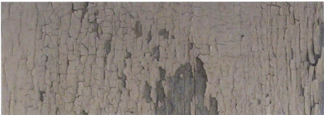
Pintakäsittely hilseilee irti alustastaan kolmannen kerroksen korkeudella.
