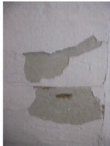
Kuva 15. Lateksi irtoaa seinästä suurina paloina
