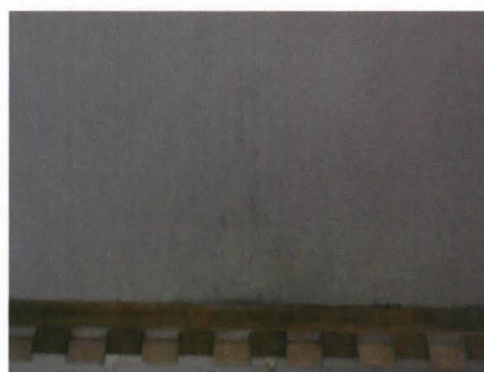
Kuva 45. Retusoitu vaurio alhaalta katsottuna
