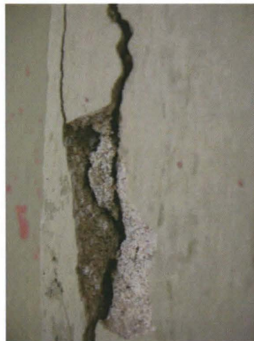
Kuva 9. Takan rappauksessa vaurio
