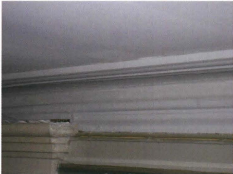
Kuva 4. Takan yläpuolella isoimmat vauriot. Kuvassa valmis retusoitu paperointi.
