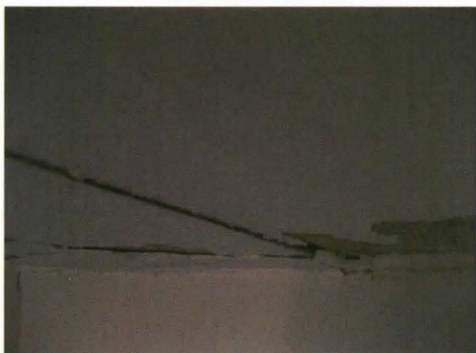
Kuva 22. Katosta irti oleva lateksilaatta. Maalin ja katon välissä n. 1cm rako.
