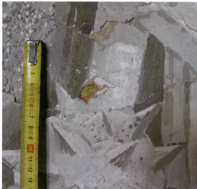
Kuva 70. Eteläseinän vauriokohta ovien oikealla puolella. (Anette Viitaniemi)
