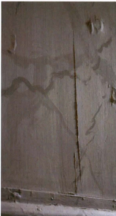
Kuva 52. Vauriotyyppi 3. Horisontaalinen halkeama, pilari G sivu I. (Mikko Iivonen)
