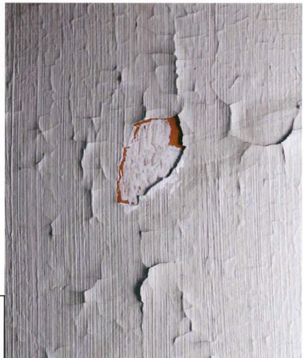
Kuva 51. Vauriotyyppi 2. Pala puuttuu, pilari I sivu III. (Riikka Kråkström)
