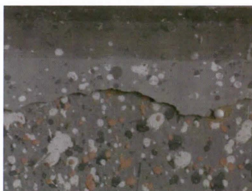
Kuva 55. Esimerkki kohta irronneesta paikkapalan reunasta. Kohta on länsiseinästä ovien vasemmalta puolelta. (Heidi Ranta)
