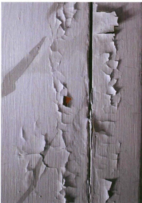
Kuva 50. Vauriotyyppi 1. Käyrityneet värikerrokset, pilari H sivu II. (Mikko Iivonen)
