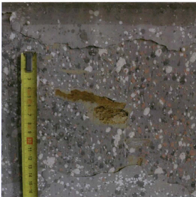
Kuva 59. Lumppupaperi on repeytynyt ja hirsi näkyvissä. Kohta on länsiseinällä ovien vasemmalla puolella. (Heidi Ranta)
