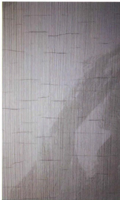
Kuva 53. Vauriotyyppi 4. Vertikaaliset halkeamat, pilasteri E sivu II. (Vilja Hedengren)
