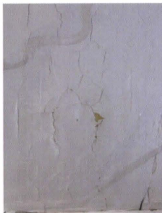
Kuva 32. Ennen ja jälkeen (kuva 33) kuvat A pilasterista sivulta II, alareunasta.
