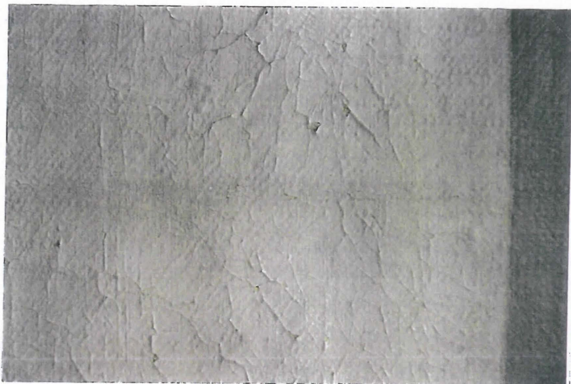
Kuva 25. Itäseinä. Krakeloitunut ja käyrästynyt väripinta ennen värinkiinnitystä.
