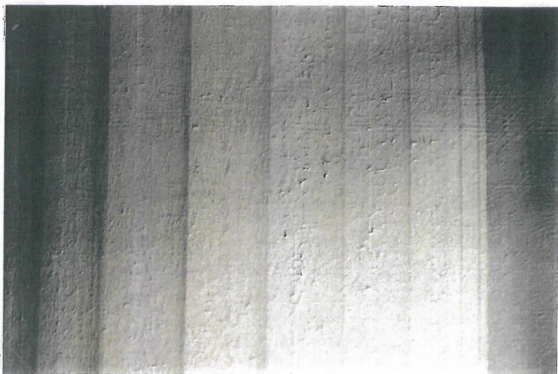
Kuva 10. Itäseinä. Samoja vaurioita kuin edellisessä kuvassa.
