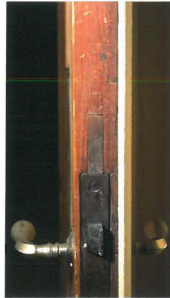
KUVA 38. Ruokasalin oven reunassa on näkyvissä oven aiempi ruskea kuultokäsittely
