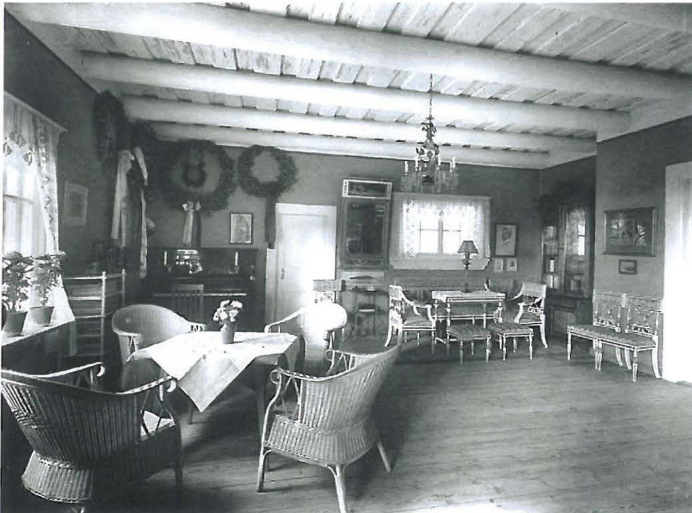
KUVA 41. Sali vuonna 1915. Kattolautojen maalipinta hilseilee pahoin. (Sundström 1915.)
