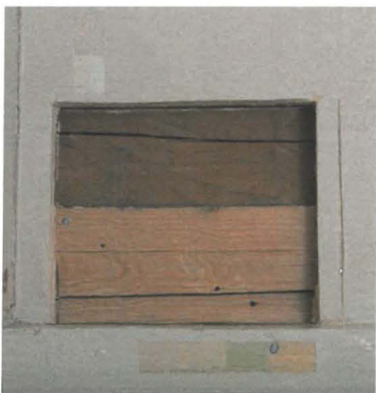
KUVA 15. Keittiön seinälevyn avaus. Levyseinän takana ainoastaan seinähirret ja luultavasti levyn naulausta varten lisätty, hirren raon peittävä puurima.
