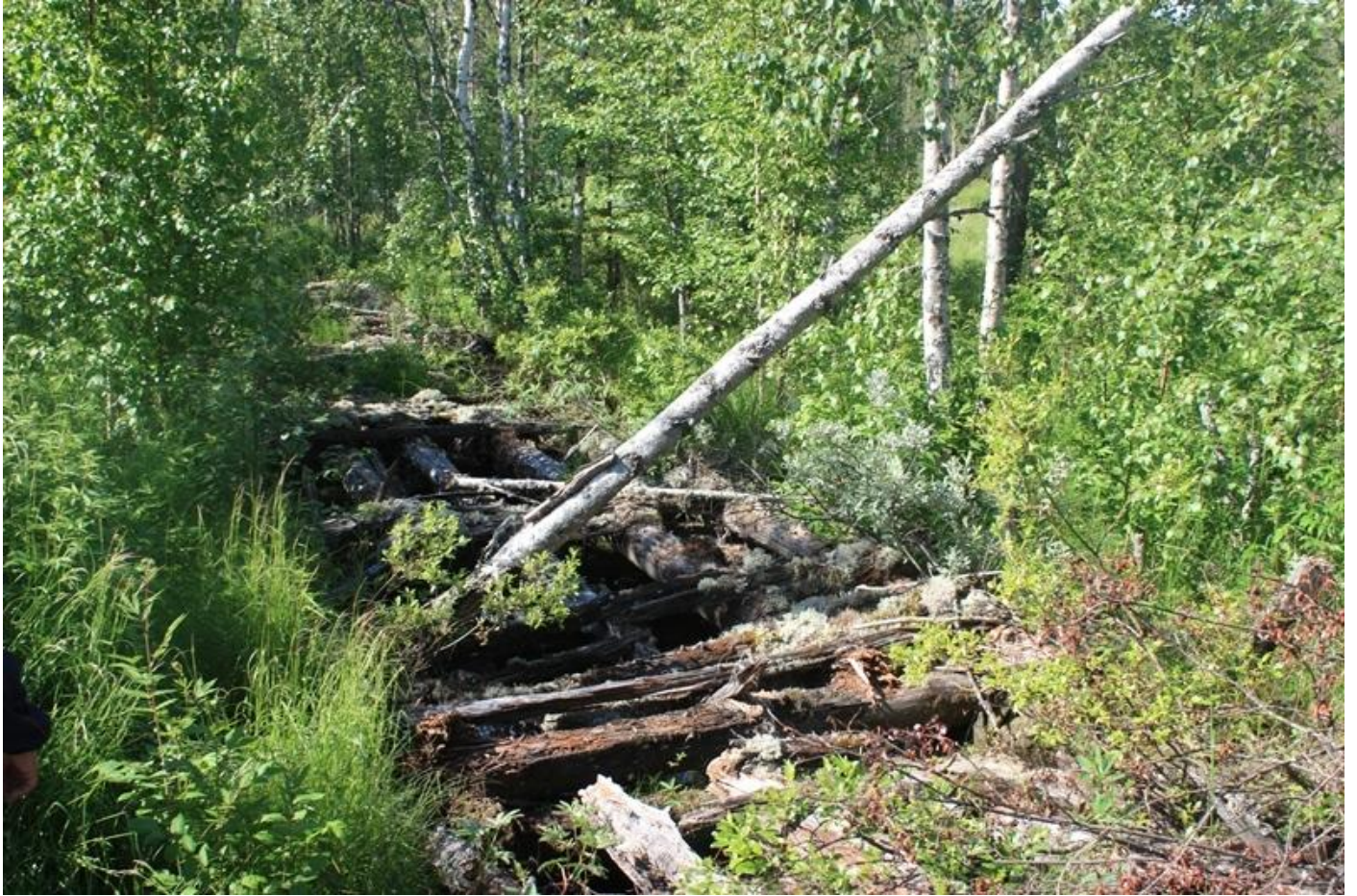
Kuva 199. Lahonnutta siltaa, kuvattu koillisesta.
