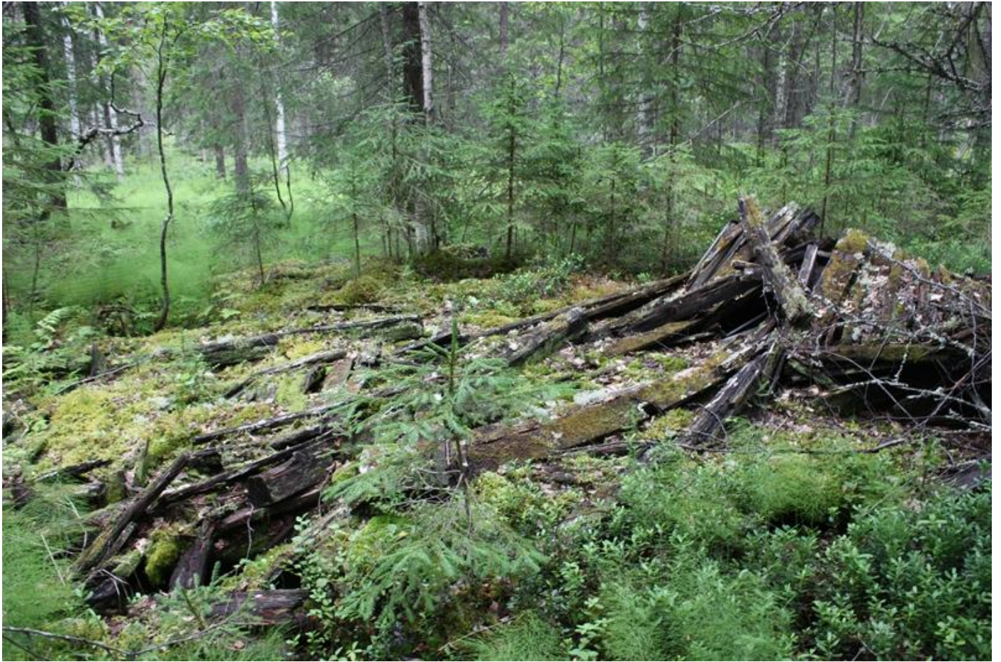
Kuva 123. Paikalleen lahonnut rakennus.
