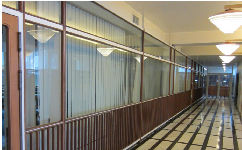
Käytävän päätteenä on valkoinen metalli-lasi-rakenteinen pariovi (AAM / Malmberg).
