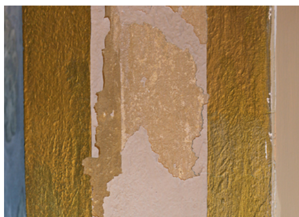
Kuva 5. Smyygien maalipinnan hilseilyä.
