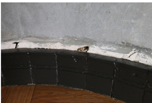
Kuva 4. Alareunan lattialistan alta paljastuvaa vaurioitunutta rappausta.
