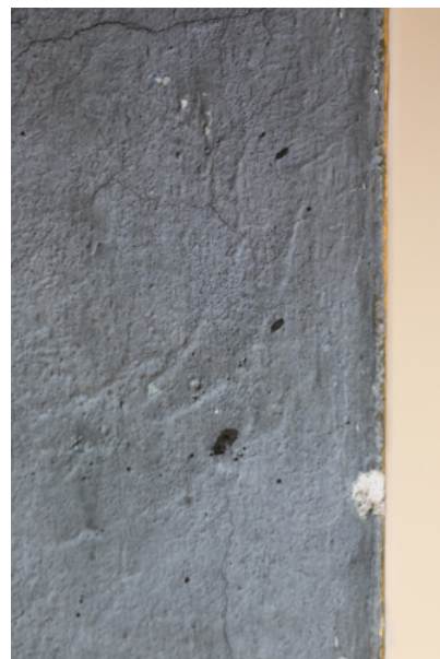
Kuva 3. Likatahroja, halkeamia ja rappauspinnan kolhu.
