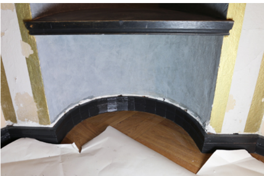
Kuva 10. Jalkalistan alta paljastunut vaurioitunut ja puutteellinen rappauspinta.
