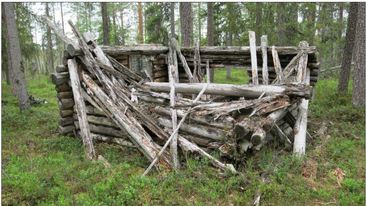
Kuva 3. Raateavaan kämpän jäännöksen romahtaneita seiniä ja kattoa kuvattuna lounaaseen. Kuva: Emilia Jääskeläinen 2020.
