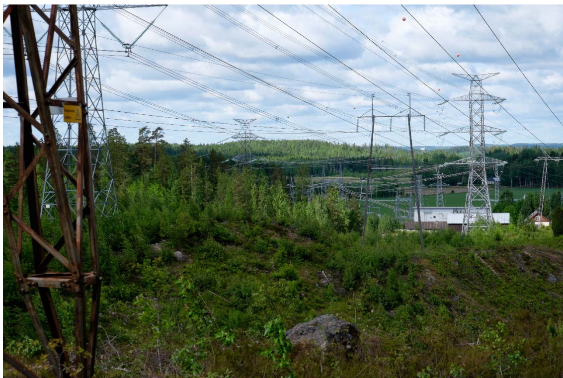
Inventoitava voimalinja alkaa Hausjärven Hikiän sähköasemalta, kuvan oikeassa laidassa. Kuva idästä. (AKDG4268:2)
